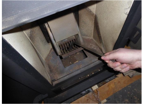
Reinigung der Lamellen des Pelletbrenners mit dem Kratzer nach dem Ausbau der Auskleidung des Brennraums.
