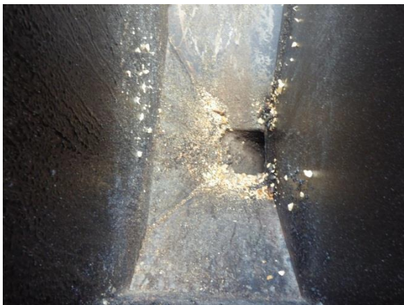
Ablagerungen durch feuchte Pellets und falsche Verwendung
