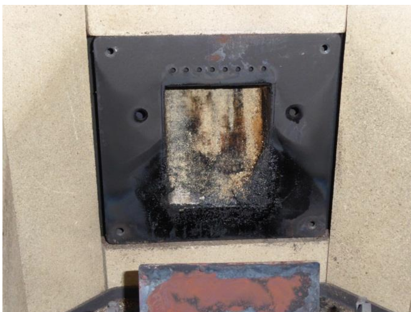
Ablagerungen am Boden des Pelletkanals nach dem Ausbau des Pelletbrenners.
